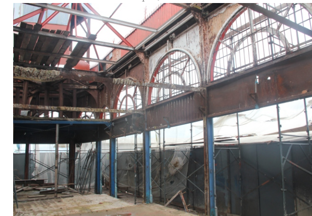
Fig. 22: Elevada corrosão de peças metálicas. Foto: Giovanni Blanco Sarquis, 2014.
