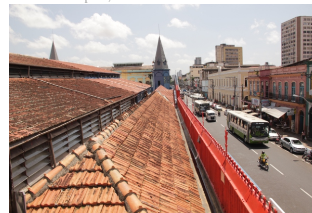
Fig. 23: Telhamento bastante desgastado. Foto: Giovanni Blanco Sarquis, 2013.
