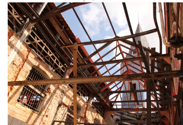
Fig. 24: Estrutura da cobertura bastante danificada. Foto: Giovanni Blanco Sarquis, 2013.
