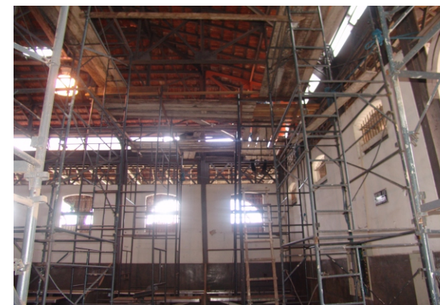
Fig. 19: Salão em péssimo estado de conservação. Foto: Giovanni Blanco Sarquis, 2013.
