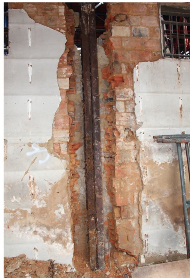
Fig. 18: Estruturas extremamente corroídas. Fonte: Acervo Iphan, 2012.
