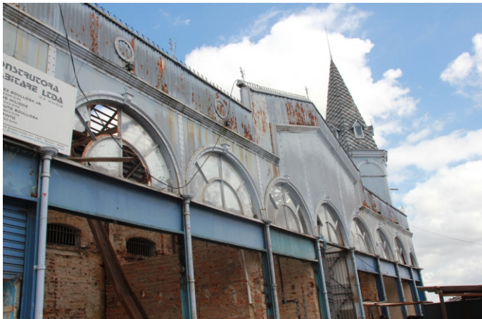
Fig. 25: Péssimo estado de conservação (corrosão) da fachada metálica. Fonte: Acervo Iphan, 2012.
