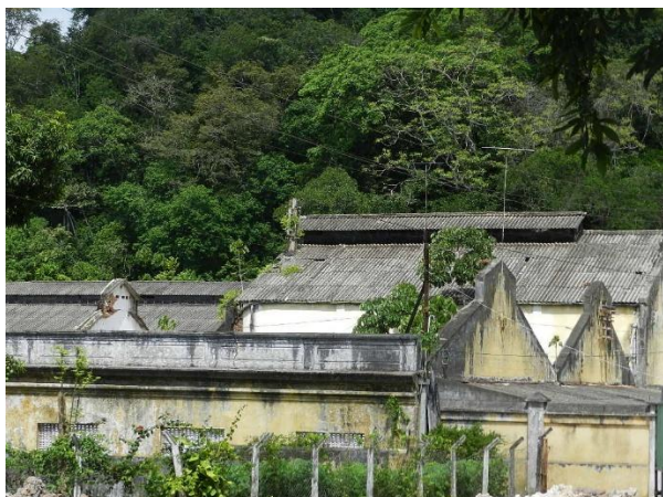
Figura 114: Trechos da edificação da fábrica sem coberta.
