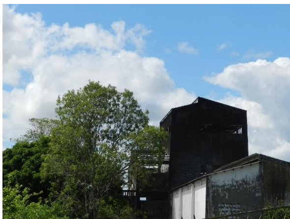
Figura 222: Demais edificações que formam a antiga Destilaria Central, sem coberta e em arruinamento.
