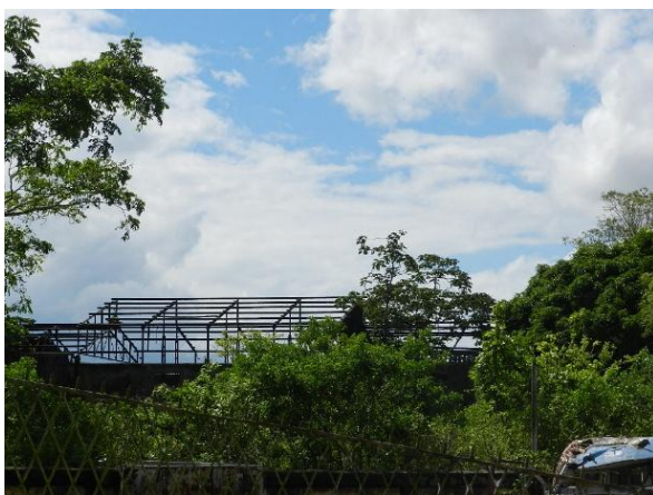
Figura 223: Demais edificações que formam a antiga Destilaria Central, sem coberta e em arruinamento.
