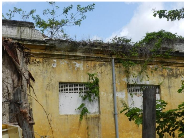
Figura 115: Trechos da fachada com platibanda destruída.
