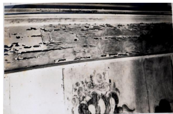
Figura 139: desprendimento da camada pictórica do forro. Fonte: ACI-RJ / Série CRBC. Data: 1971
