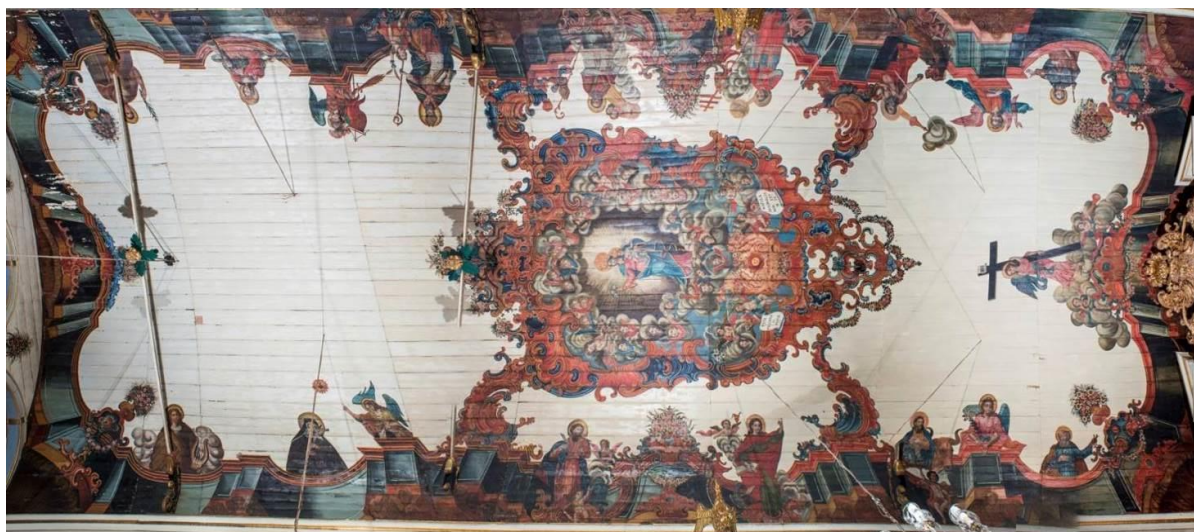
Figura 58: Foto atual do forro da nave. Acervo ETSJDR (IPHAN, 2016). Foto de Miguel Aun. Data: v2015
