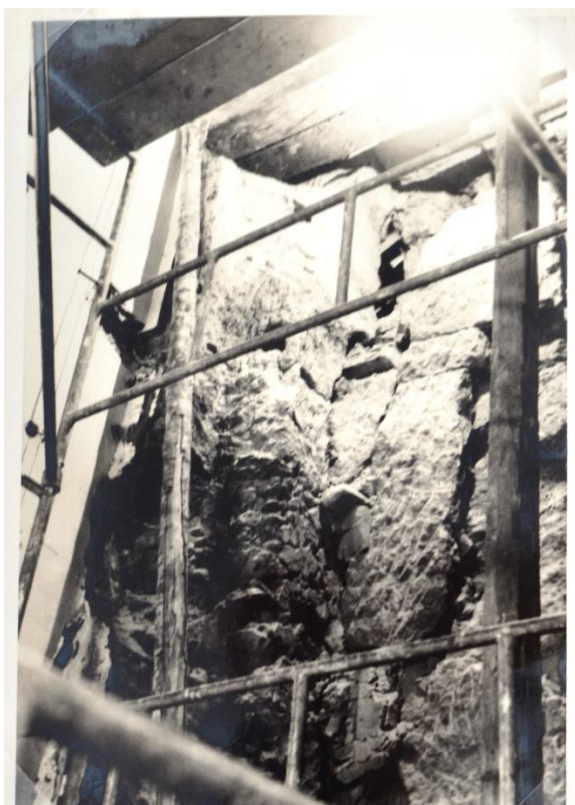
Figura 97: Parede de taipa ao qual o retábulo era integrado totalmente trincada e em desprendimento. Fonte: ACI-RJ / Série CRBC. Data: 1970
