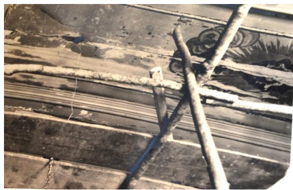
Figura 141: Forro da Capela do SS. Sacramento – desprendimento de camada pictórica. Fonte: ACI-RJ / Série CRBC. Data: 1971
