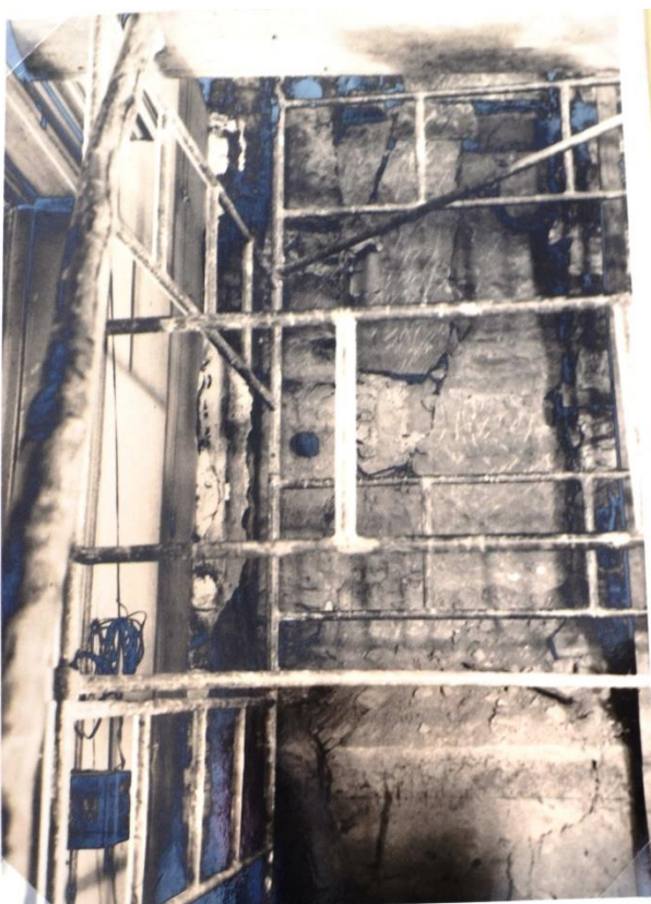
Figura 119: Trincas e desprendimento da taipa da parede ao fundo do altar de N. Sra. da Boa Morte. Fonte: ACI-RJ / Série CRBC. Data: 1970
