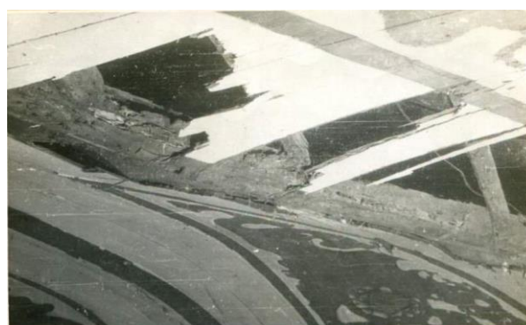
Figura 44: Forro da capela-mor - precário estado do madeiramento devido viga apodrecida. Fonte: ACI-RJ / Série CRBC. Data: 1958.
