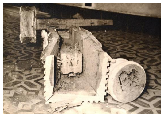
Figura 82: Estado de conservação de peça de madeira atacada por térmitas na Igreja de N. Sra. do Carmo de SJDR. Fonte ACI-RJ / Série CRBC. Data: 1961
